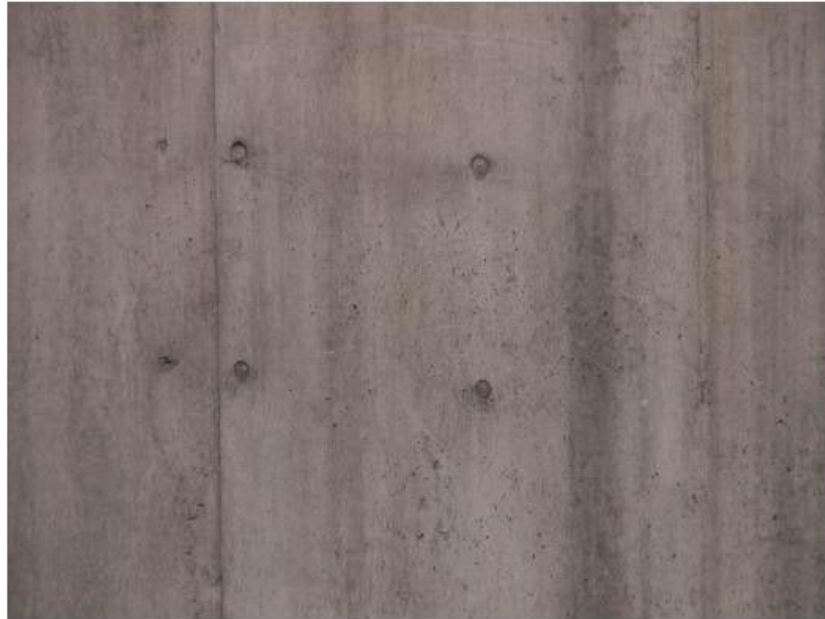
図4. 型枠支持具痕
